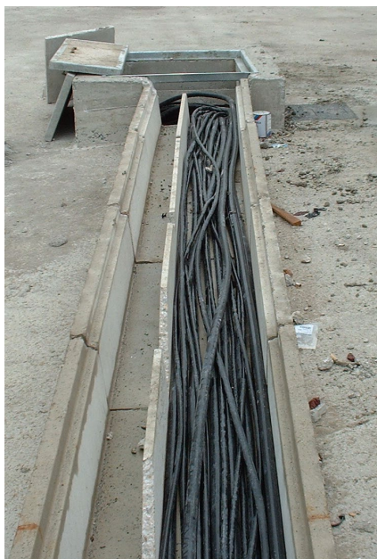
Figura 30. Tira de cables
